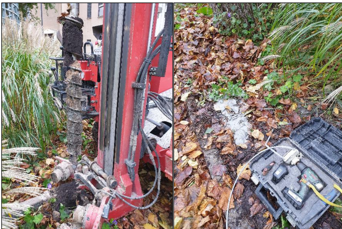
Figur 6. Till vänster översta jordlagerföljden från skruv 20-01 där det senare installerades ett GV-rör. Till höger rensumpning innan grundvattenprovtagning.
